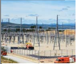
Poste électrique THT (2012)
